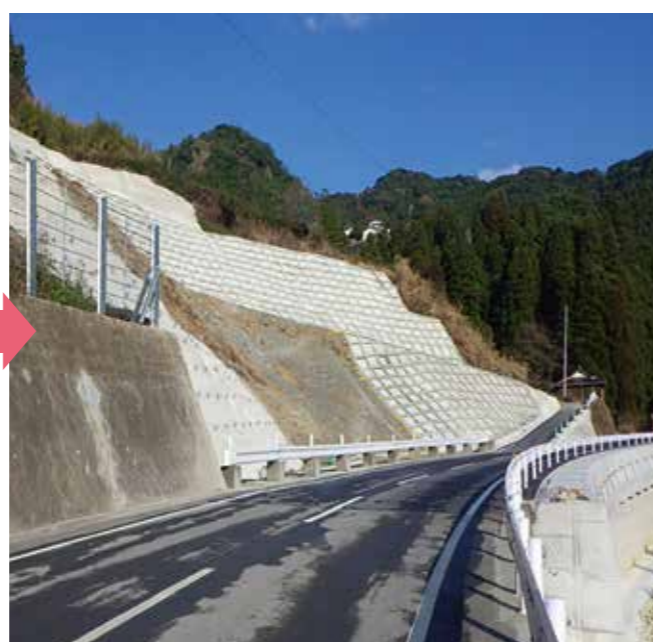
▲県道後川内黒木線 黒木笠原不動館手前付近(復旧工事後)
