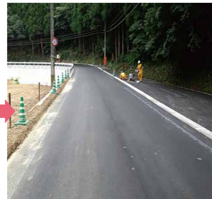
▲県道岩野黒木線 黒木町(仮復旧工事後)
