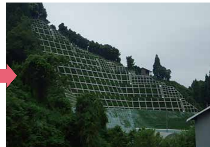
▲黒木町下名地区(復旧工事後)
