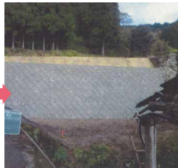
▲星野村狸穴(復旧工事後)
