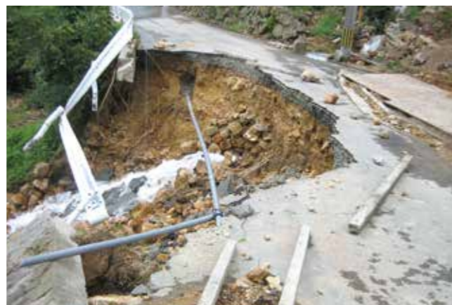
▲星野村本星野地区簡易水道 配水管
