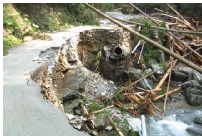
▲星野村小野地区簡易水道配水管
