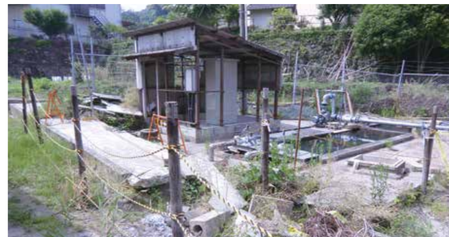
◀星野村十籠地区簡易水道 下井手ポンプ所
