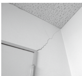
庁舎内のひび割れ(クラック)
