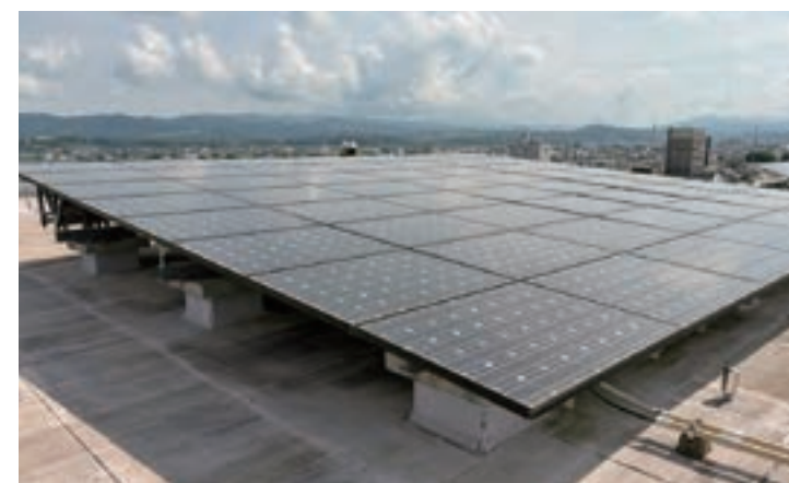
屋根置き太陽光発電(市役所屋上)
