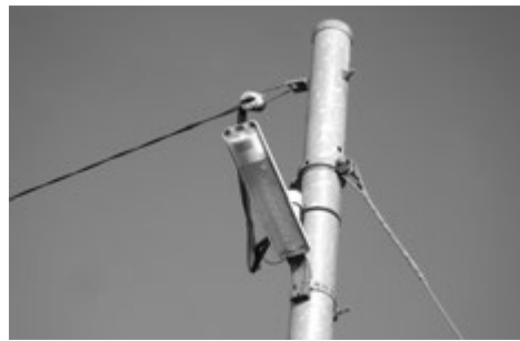
電柱に設置された公共灯
