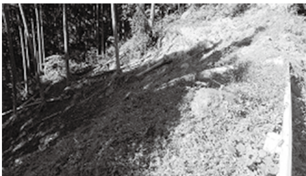
③矢部村内、林道矢部線崩壊現場
