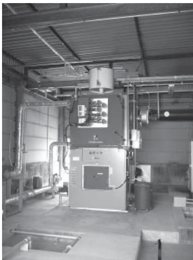
べんがら村に導入している木質バイオマスボイラー
