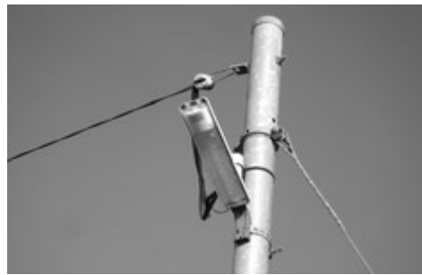
電柱に設置された公共灯
