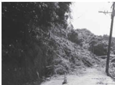
①市道遠久谷鹿子生線崩壊現場
