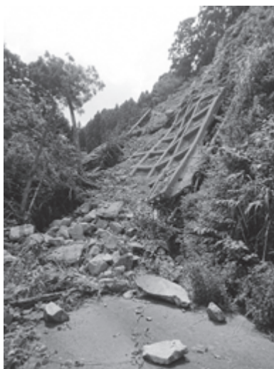
③星野村の林道古城線崩壊現場
