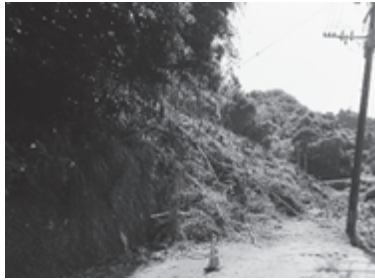
①市道遠久谷鹿子生線崩壊現場
