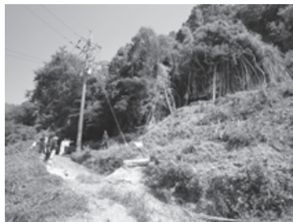
遠久谷・鹿子生線の法面崩壊現場
