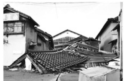
能登半島地震で被災した家屋 (石川県珠洲市飯田町)
