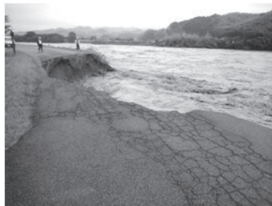
平成24年九州北部豪雨時の矢部川矢原堤防
