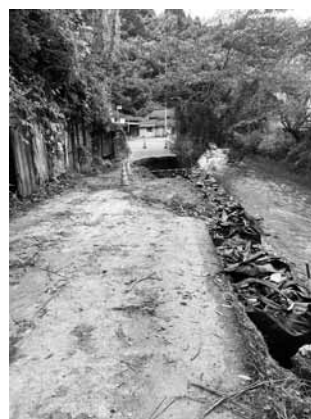
大雨で通行止めになった県道
