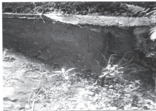
市道広川線荒廃状況
