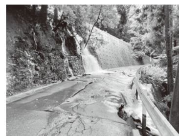
大雨で崩壊した市道
