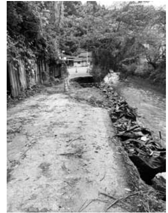
大雨で通行止めになった県道
