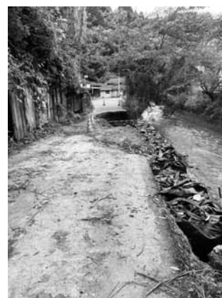
大雨で通行止めになった県道
