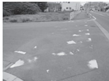
通学路にある白線が消えている横断歩道
