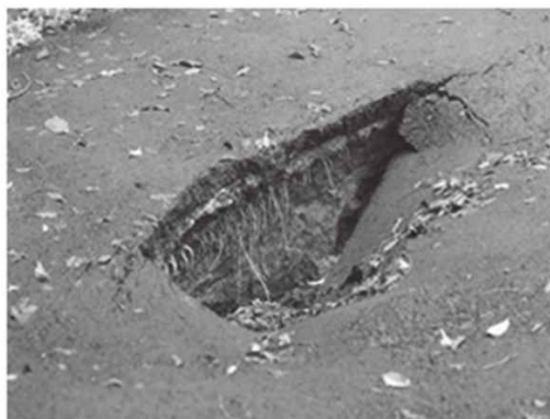
陥没した道路
