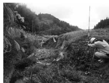
復旧工を進めるための被災箇所の調査
