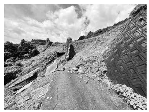
農地と農道が崩落した被災現場
