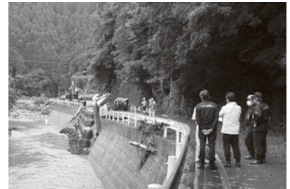
路肩が崩落した県道田主丸黒木線
