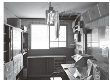
天井が破損している放送室
