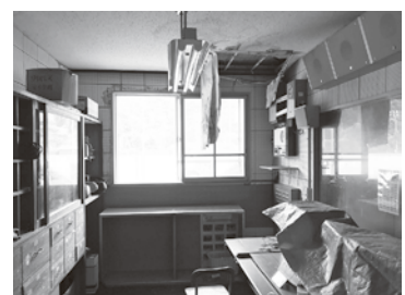
天井が破損している放送室
