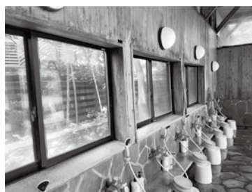
柱などが腐食した池の山荘の浴室
