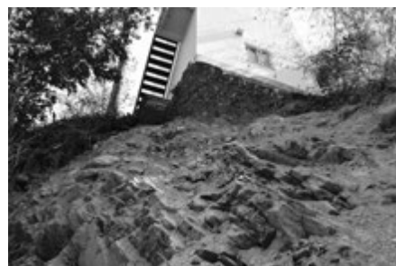
詰所裏の崩落箇所
