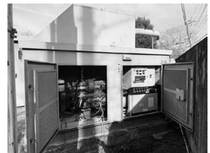
立花庁舎の非常用発電設備
