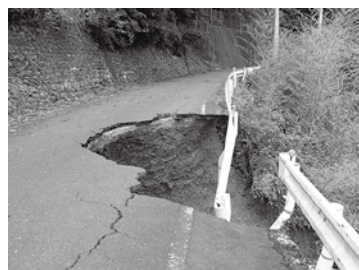
7月豪雨災害後の久木原中央線(上陽町)
