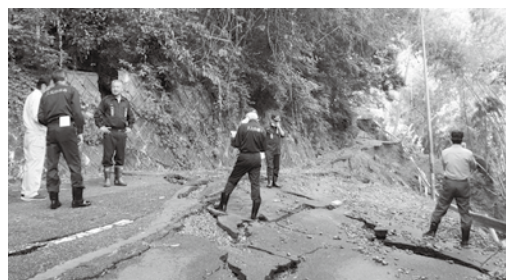
ひび割れ路肩が崩壊した下辺春・白木線
