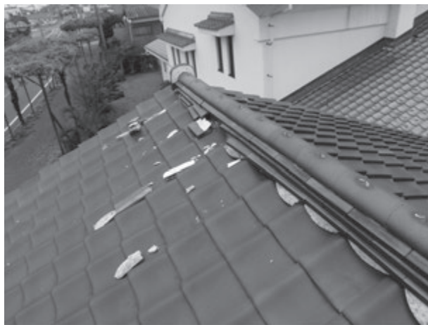
屋根瓦が破損し、修繕工事が必要な八女伝統工芸館
