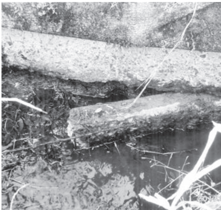
老朽化した水路(新庄地内)
