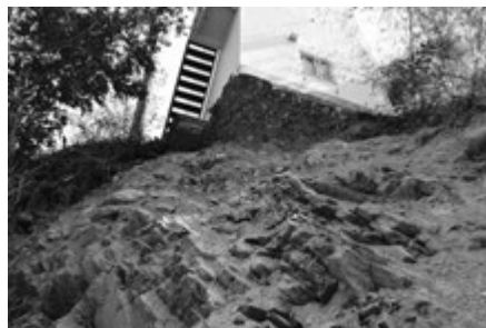
詰所裏の崩落箇所
