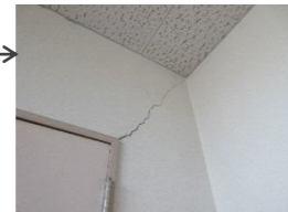
庁舎内のひび割れ(クラック)
