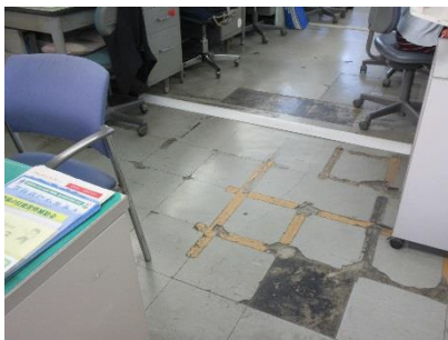
床材の剥がれや床上配線のようにす
