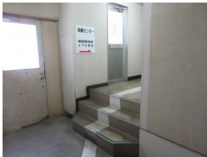
移動空間における段差
