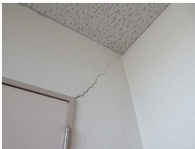
庁舎内のひび割れ(クラック)
