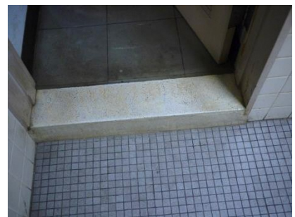
トイレ入り口部分の段差
