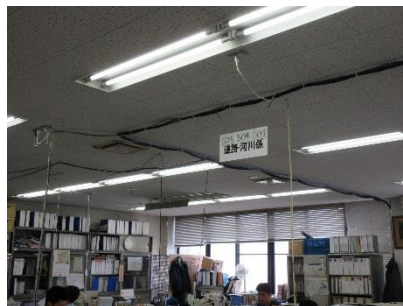
天井からむき出しの配線
