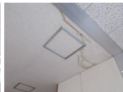
漏水による天井のシミ
