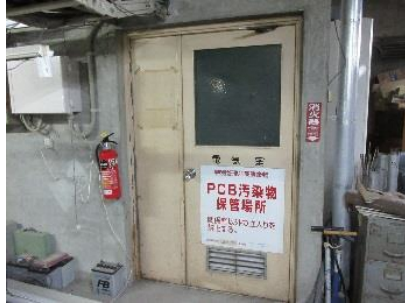
地下にある電気室
