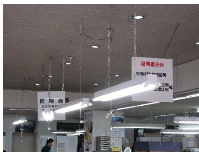
電気設備の老朽化
