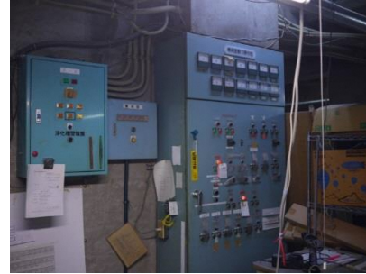
古い設備システムを採用
