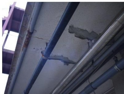
仕上げ材の剥離などの劣化
