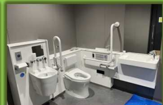
1~4階の各階にバリアフリートイレを設置しています。
