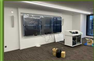
3階の大会議室にマルチモニターを設置。災害時には対策本部として機能。
