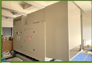
5階 非常用発電設備
