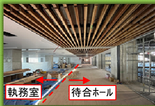
2階 待合ホール側天井に、八女スキの木製ルーバーが設置されました。
