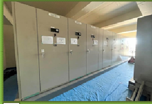
5階 受変電設備
