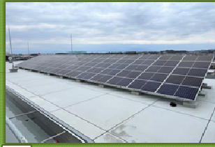
屋上 太陽光発電設備
