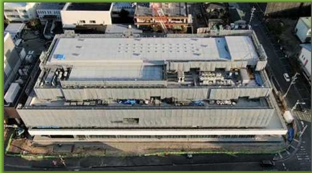
新庁舎棟工事全景（令和5年11月2日 敷地南側よりドローンにて撮影）
