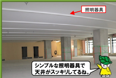
1階 執務室の照明器具
