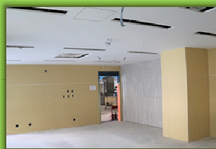
1階 壁・天井のボードが貼付けられました。穴が開いている部分は照明器具や空調機器を取り付ける部分です。
