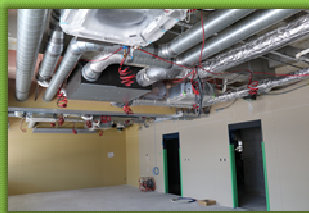
2階 多くの設備機器や配管・配線が、天井内の限られた空間の中に計算され設置されています。
