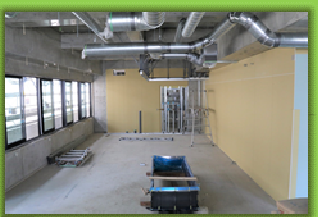
2階 7月上旬に躯体工事の片付を終え、サツの取付、配管・配線、内装工事を開始しました。
