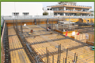
1工区は2階床の鉄筋立組みも進んでおり、3月3日にコンクリート打設の予定です。
