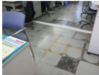
床材の捲れや床上配線の様子
