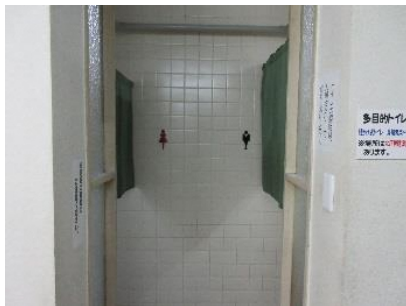
入口扉がなく、狭いトイレ
