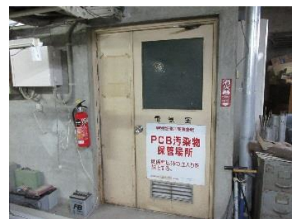
地下にある電気室
