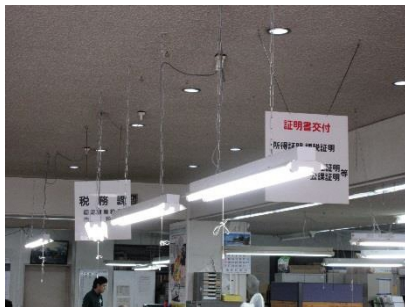
電気設備の老朽化
