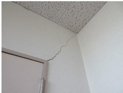
庁舎内のひび割れ(クラック)
