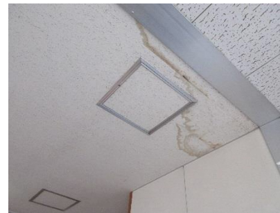
漏水による天井のシミ
