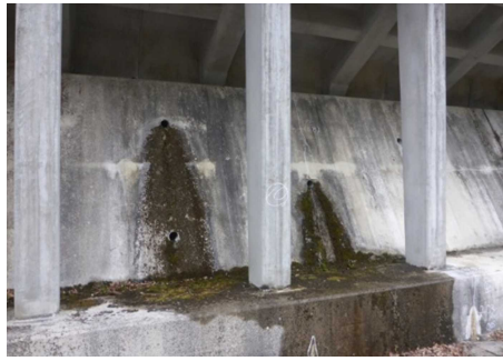
熊の内3号ロックシェッド (山側受台の漏水跡：Ⅱ)
