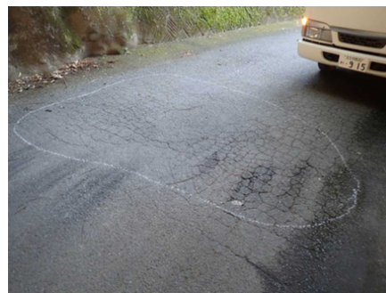
鳥越トンネル（舗装のひびわれ：Ⅱb）
