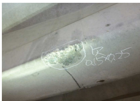
熊の内2号ロックシェッド (主梁の欠損：Ⅱ)
