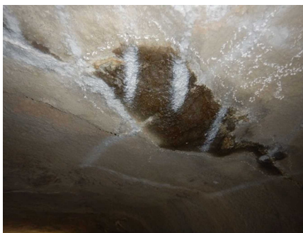
熊の内隧道（覆工の漏水：Ⅱb）
