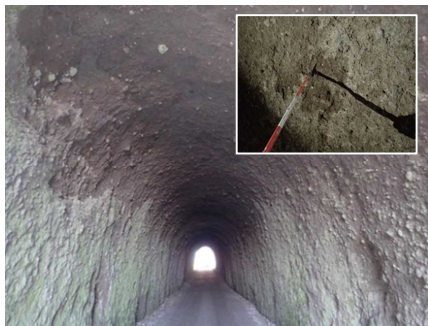
後田トンネル（覆工地山の風化：Ⅱa）
