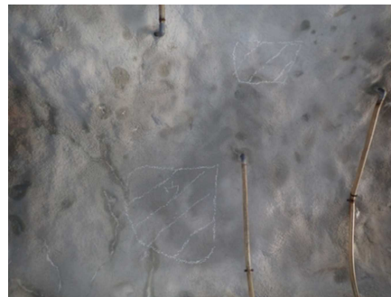
小詰トンネル（覆工吹付以外のうき：Ⅱb）
