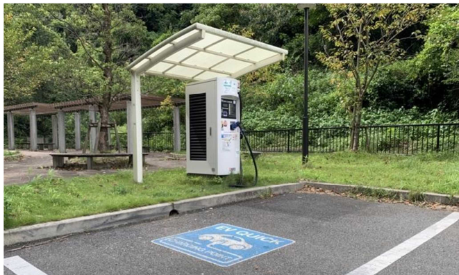
写真：道の駅たちばなに設置されているEV充電ステーション
